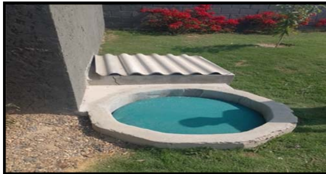
Visita de evaluación de permiso de vertimiento - Pozo de recepción de aguas residuales.
