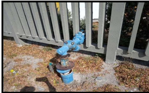
Visita de seguimiento y control a concesión de aguas subterráneas del sector industrial.
